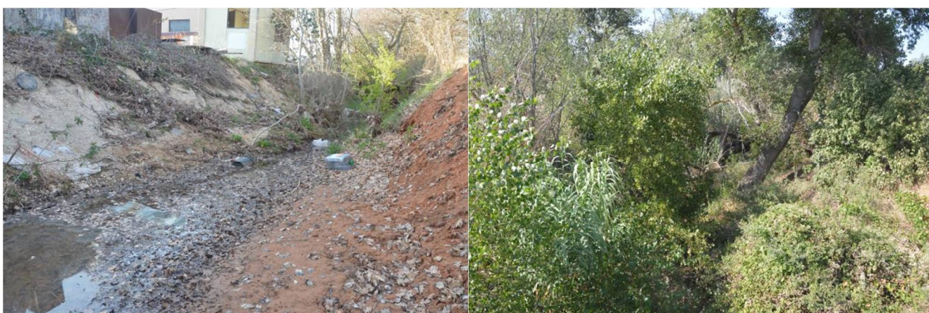
Figure 8 Fossé du Devens pollué et/ou obstrué (juste avant le Pont RD900) par la végétation sur la zone d'étude
